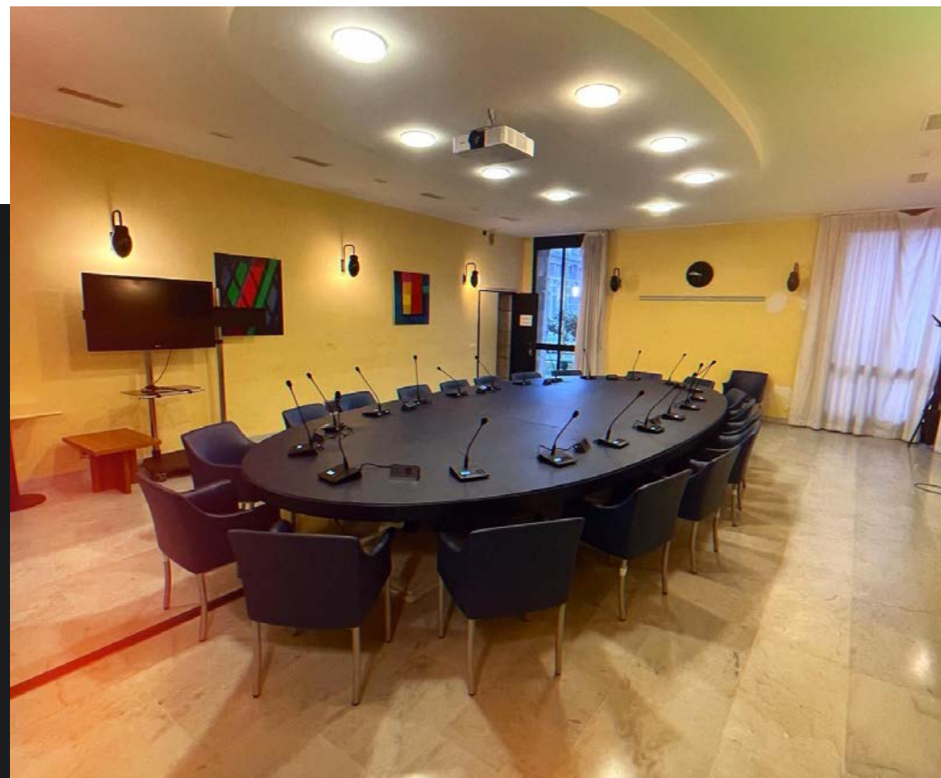
*COMUNE DI GENOVA - Fornitura e Installazione dell'Impianto Microfono della Sala Giunta Nuova di Palazzo Tursi.
